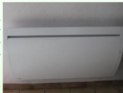
Chauffage du rez-de-chaussée de la mairie
