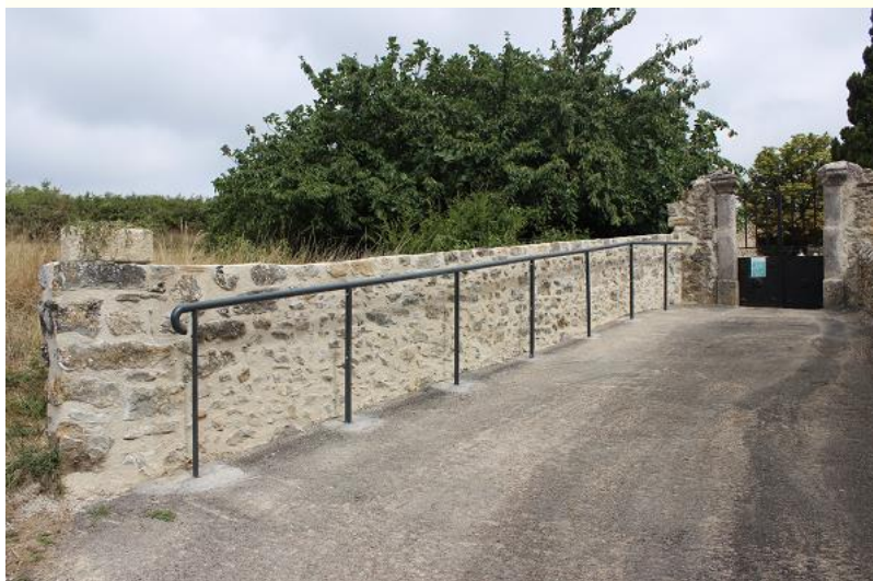
La main courante de la rampe d'accès au cimetière
