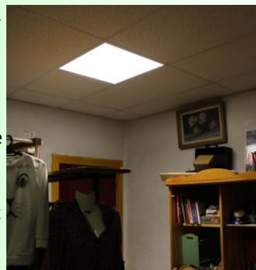
Point lumineux installé à la friperie
